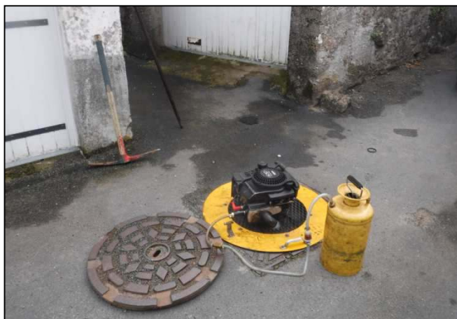
Ventilateur injectant de la fumée au niveau d'un regard
