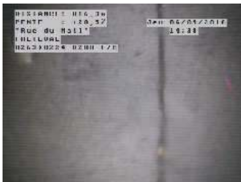
Fissure ouverte – Rue Marie Tessier
