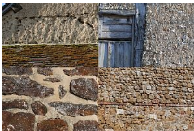
Mélange de matériaux variés dans la construction percheronne : torchis, pans de bois, rognons de silex, roussard, moellons calcaires...
